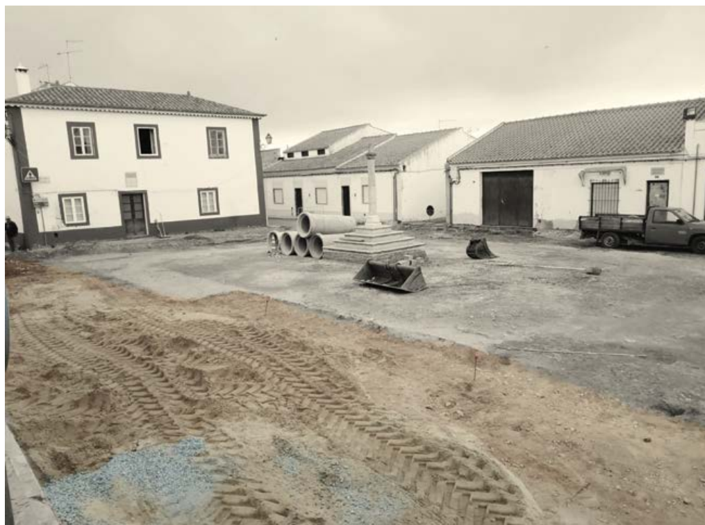
Vista sudeste do solo antigo, documentado nas escavações, Praça D. Manuel I, Alvalade.
